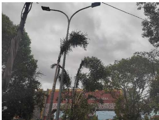
Kondisi tiang lampu PJU di Jalan Gajah Mada
