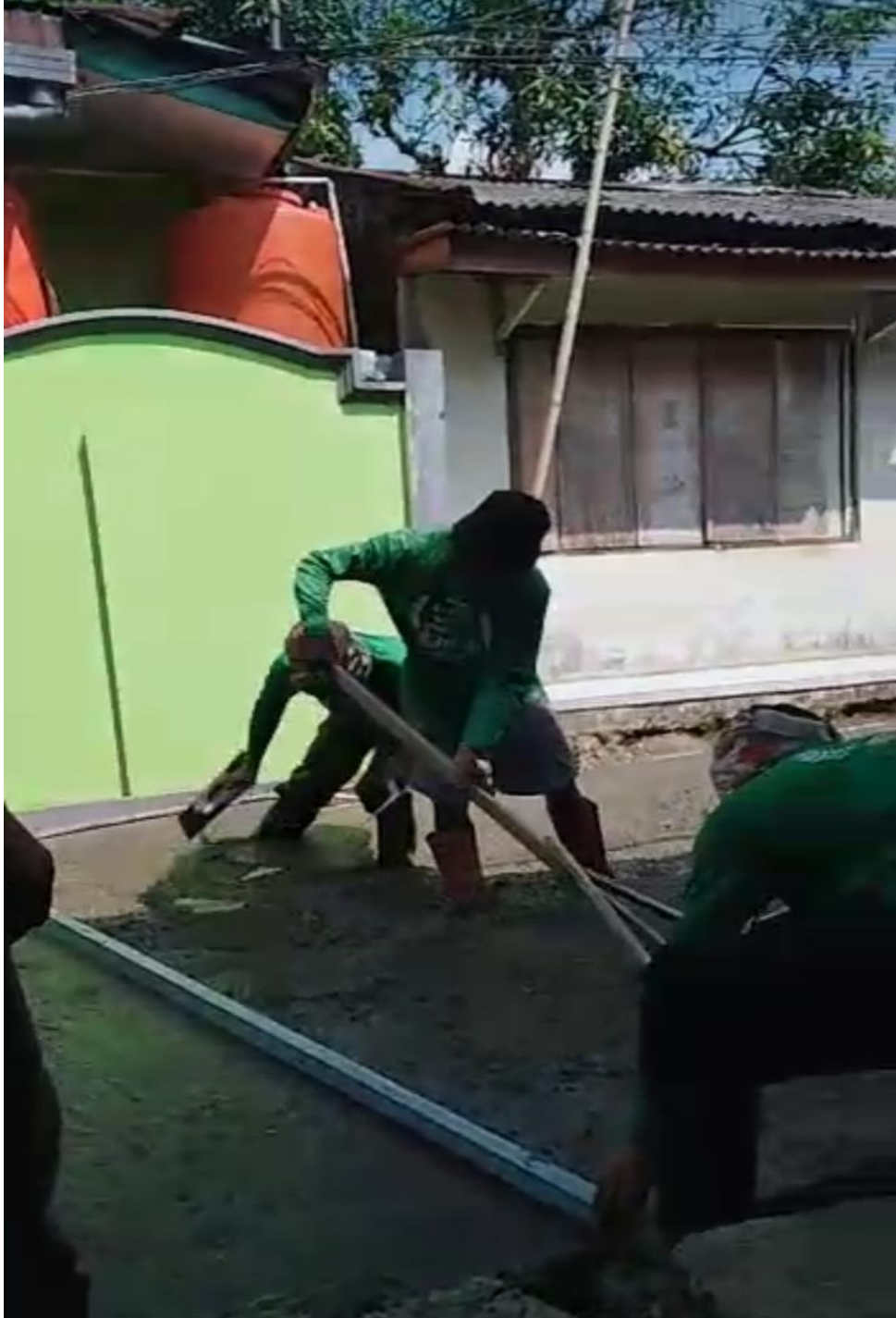
Foto Kegiatan Gotong Royong Memperbaiki Jalan yang rusak
