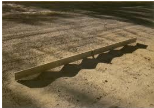
Gambar 2.10. Bergelombang/Keriting (sumber : Departemen Pekerjaan Umum, 2007)
