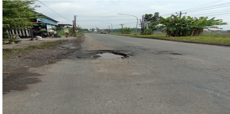
Gambar 1.1. Kondisi Ruas Jalan Pangkah – Balamoa ( Sumber : DPUPR Kab. Tegal Tahun 2023 )
